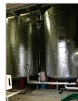
給湯タンク設備
