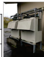
ヒートポンプユニット
